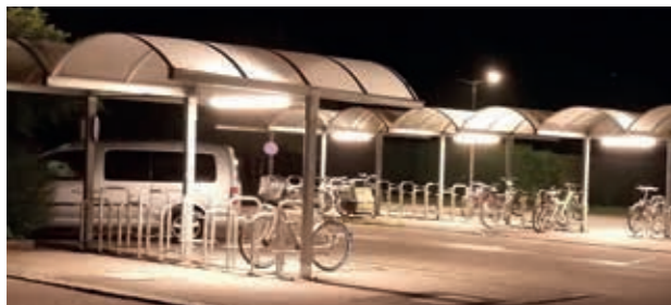
Neue Beleuchtung der Fahrradständer am Bahnhof
